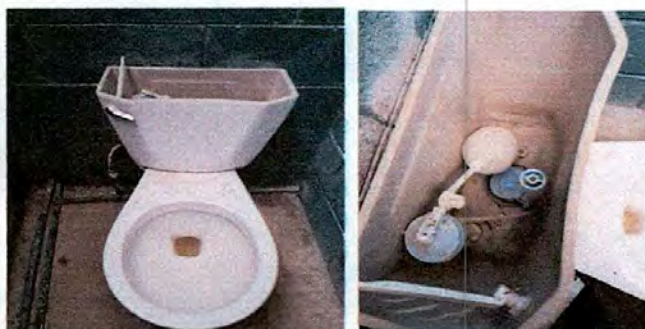
FOTO 9: SERVICIOS SANITARIOS Y ACCESORIOS
